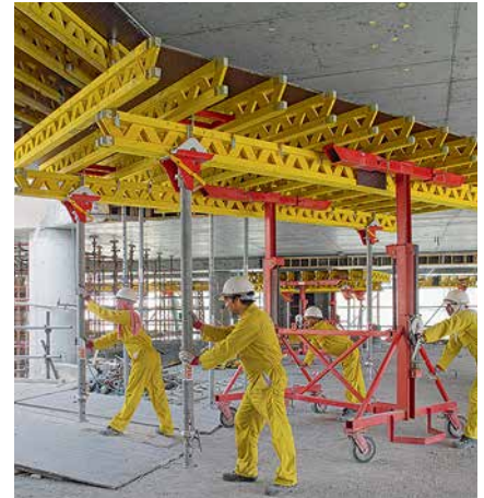
Insbesondere bei großen Deckenstärken und hohen Lasten werden Deckentische mit den tragfähigen GT 24 Schalungsträgern ausgeführt.
