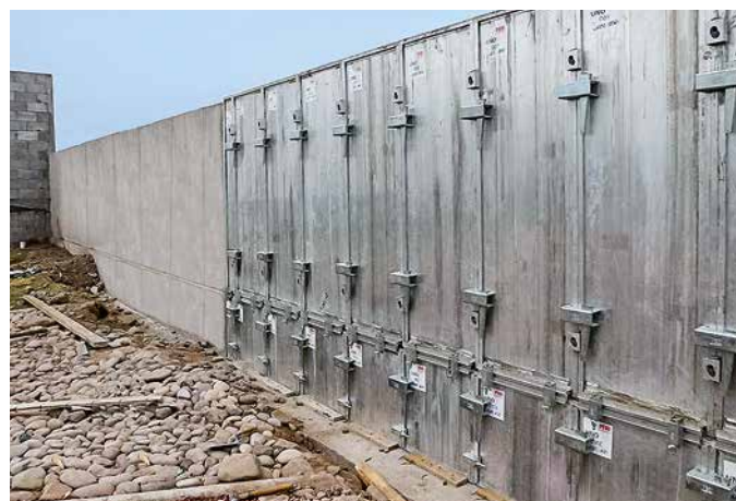
Wohnanlage in Mazatlán, Mexiko Einhausung des Wohnquartiers Stahlbetonwände mit 2,40 m Höhe Ausführung mit 12 m langen Betonierabschnitten
