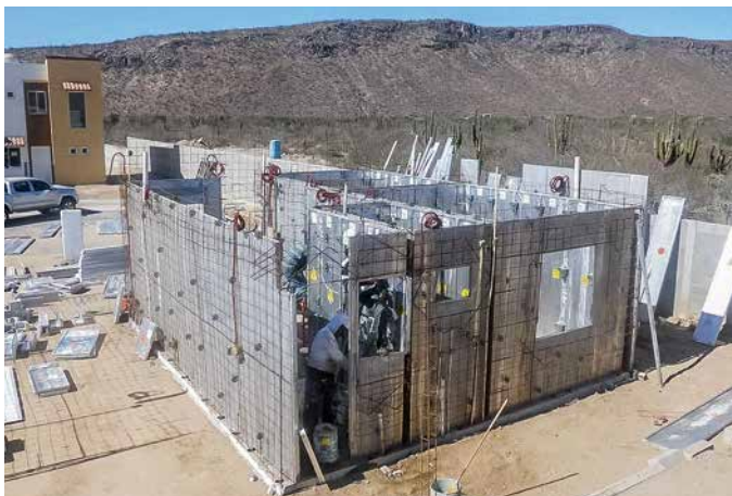
Musterhaus Bahía / Musterhaus Península Wohnanlage in La Paz / Baja California Sur, Mexiko 1.200 Häuser Typ Bahía | 2.000 Häuser Typ Península Je Haus 1 Geschoss mit 45 m 2 bzw. 55 m 2 Grundfläche
