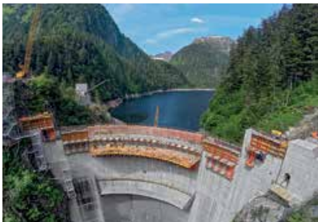
Ein Staudamm wurde aufgestockt: Im Rahmen der Erweiterung eines Wasserkraftwerks war diese Staumauer in Alaska zu erhöhen.
