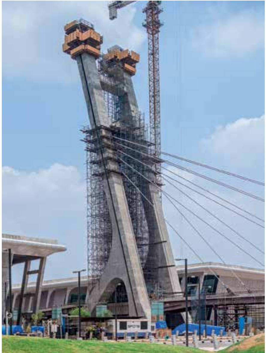
Großzügige und sichere Arbeitsbereiche auf allen 3 Ebenen.
